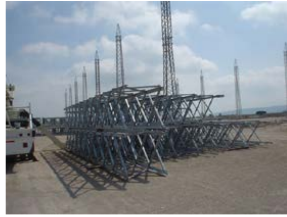
QUERETARO POTENCIA 400 KV
